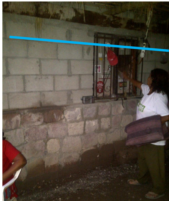
Imagen 122: Vivienda afectada en las Pocitas por inundación huracán John 2006 propiedad de la Sra. Tomasa Murillo indica el nivel que alcanzó el agua. Fotografía Julio Villarreal
