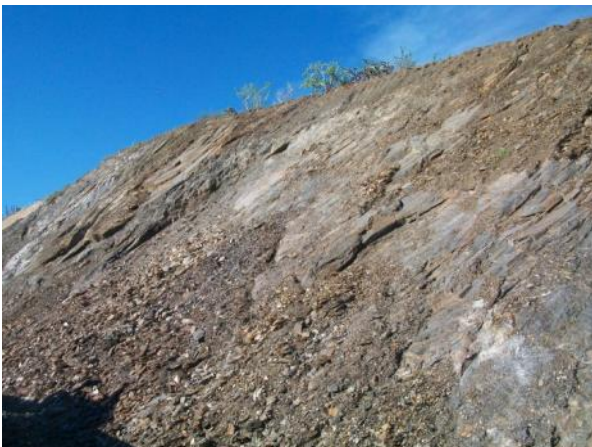
Imagen 53. . Se observa deslizamiento de ladera en rocas pizarrosas sobre la carretera La Paz-Todos Santos. Foto P. Sámano
