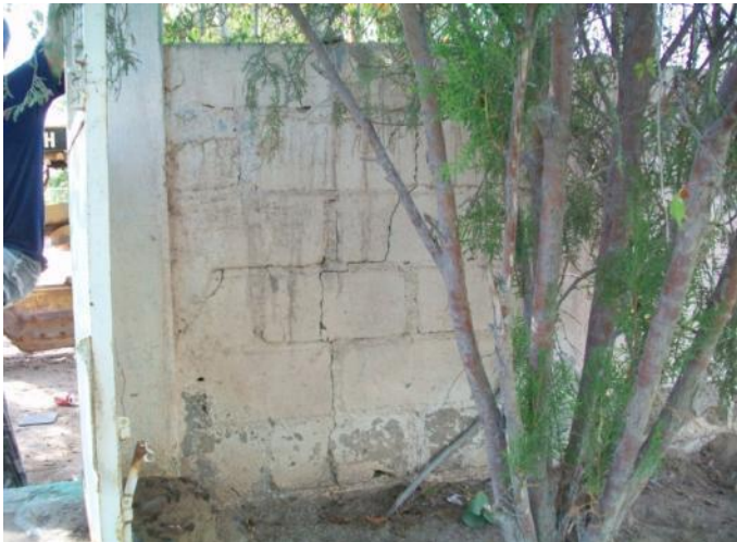
Imagen 20. Vivienda con barda fracturada por el sismo de 2007 en El Centenario. Foto P. Sámano
