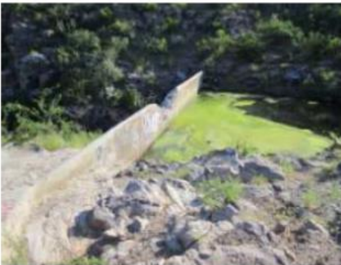
Imagen 136: Condiciones actuales de la cortina .Fotografía J. Villarreal
