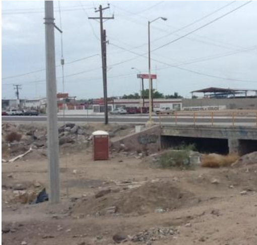
Imagen 129: Diseño inadecuado de alcantarilla aguas debajo de la gravera arroyo demasías la Huerta.
