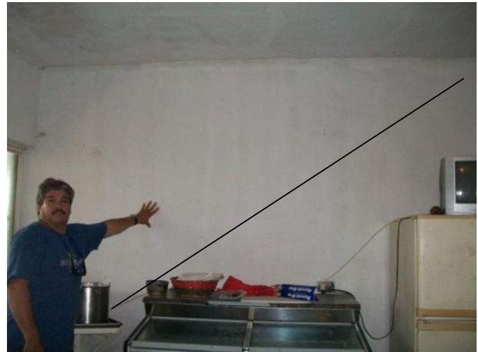
Imagen 21. Se observa el muro con falla estructural (fisura a 45°) en una vivienda en El Centenario. Foto P. Sámano
