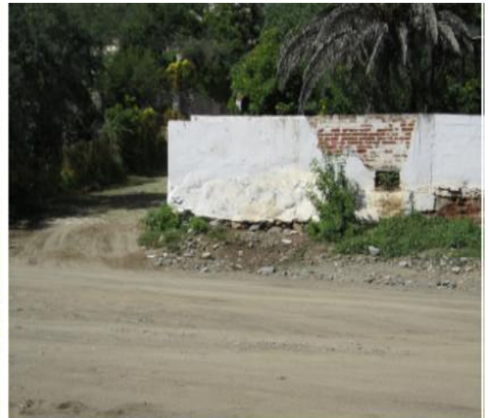
Imagen 155: Muro de mampostería en riesgo de colapso en construcción junto al arroyo San Antonio. Fotografía Julio Villarreal
